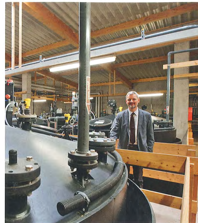
Jäcklechemie-Chef Robert Späth ist stolz auf das neue Chemikalien-Tanklager.
